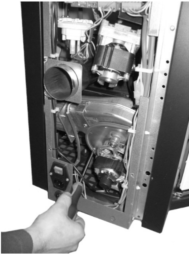
Fig. 104 - Reinigung Rauchgasansauggerät: Phase 1
